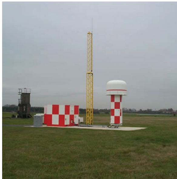
Figure 17.4 PAR installation at RAF Marham
